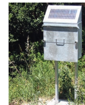
Station hydrométrique de Salon-de-Provence
